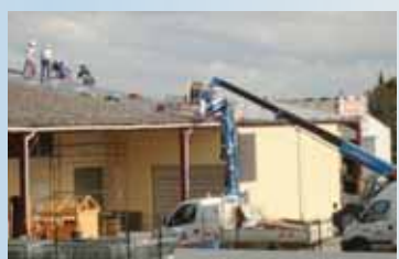
Installation photovoltaïque réalisée sur les bâtiments techniques de la commune de Fauillet [47400]
